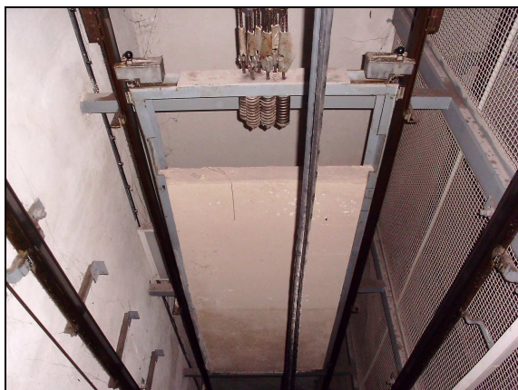
obr.5 – pohled na protiváhu výtahu č.1
