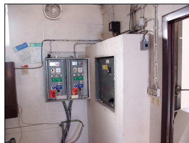
obr.15 – hlavní vypínače výtahů
