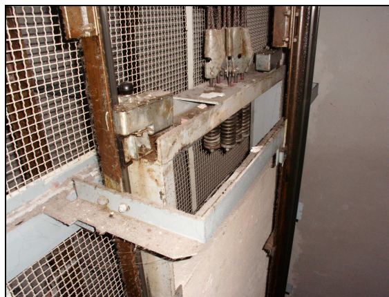
obr.6 – pohled na protiváhu výtahu č.2
