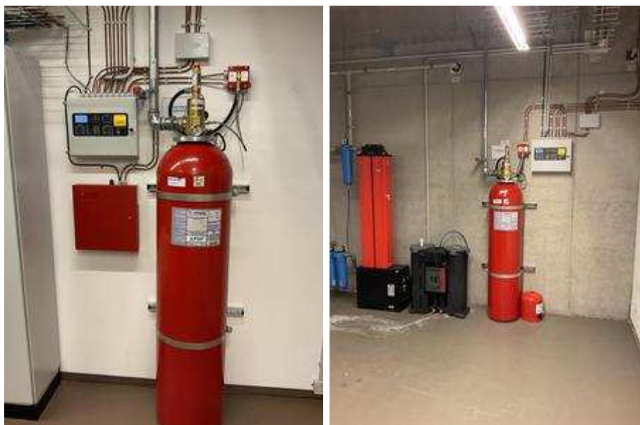
Obrázek 2 - SHZ v prostorách serverovny a kompresorovny
